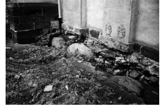
2004 wurden auf der Nordseite Teile des Fundamentes frei gelegt. Das Profil unter den beiden Epitaphien gehört noch zum Vorgängerbau Anfang des 12. Jahrhunderts.
