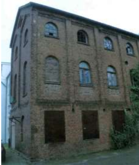
Das Gebäude in schon schlechtem Zustand um 2002 (Kommunalarchiv).
