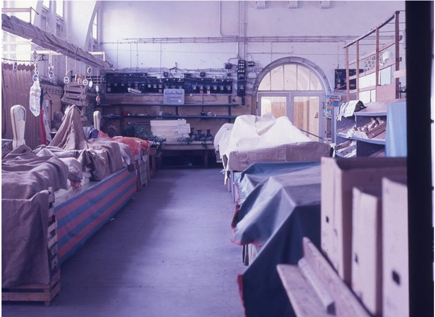
1985 Blick in die Markthalle vor der Sanierung – Stromverteilung (Foto: Kommunalarchiv)
